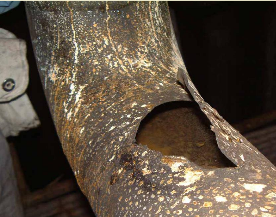
高温硫化氢和氢腐蚀失效
